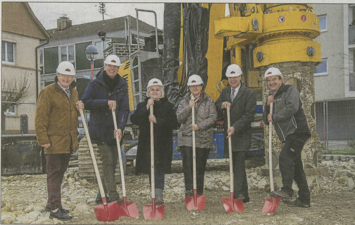
Ex- Aufsichtsratsvorsitzender Georg Volles, Oliver Nussbaum, Sandra Achilles, Aufsichtsratsvorsitzende Erna Diener, Volker Schmelzle und Jürgen Merkle von der Volksbank Haustechnik (v.l.) beim Spatenstich. Foto: Zimmermann
